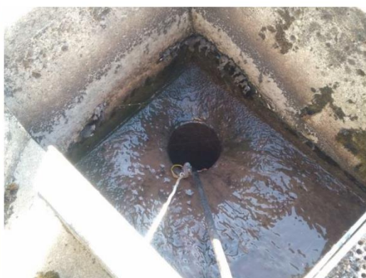
Point de prélèvement et de détection de surverse
